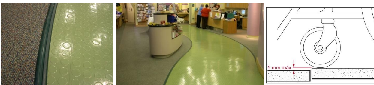
Foto 48 y 49: Alfombra y piso vinílico firmemente adheridos y unidos. (Fotos: Ximena Rosello) Fig. 49: Desnivel máximo entre juntas de piso terminado.
