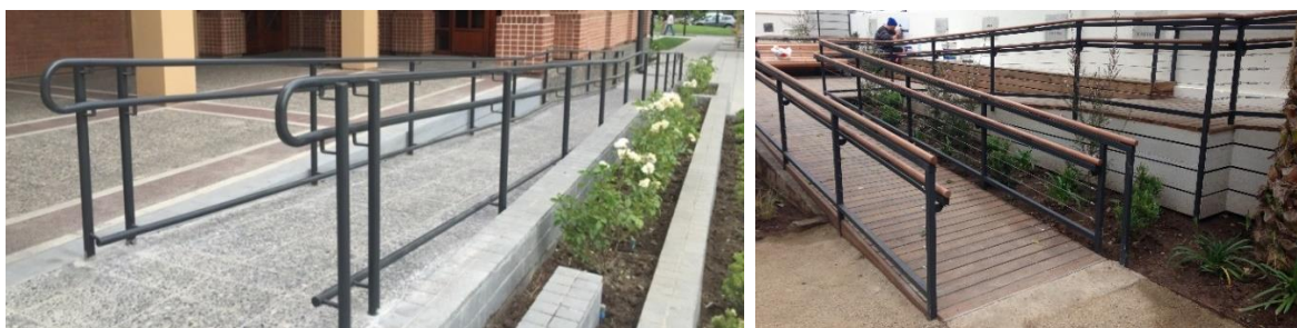
Fotos 53 y 54: Rampa con pasamanos a doble altura. Ambos pasamanos deben ser continuos, de manera que el deslizamiento de la mano no se interrumpa en todo el trayecto.
